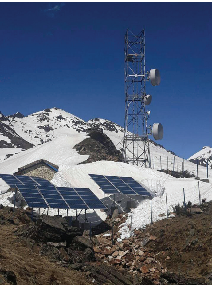
हुम्लाको किरिनेखर्कमा अवस्थित नेपाल टेलिकमको माइक्रोवेभ रिपिटर स्टेशन।
