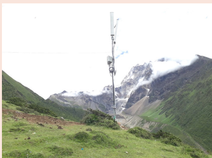
साम्दोमा रहेको नेपाल टेलिकमको BTS
